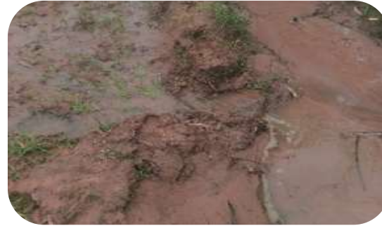
RUPTURE DU CANAL LATERAL
