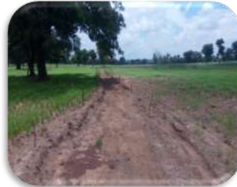
Colature rongée par l'eau
