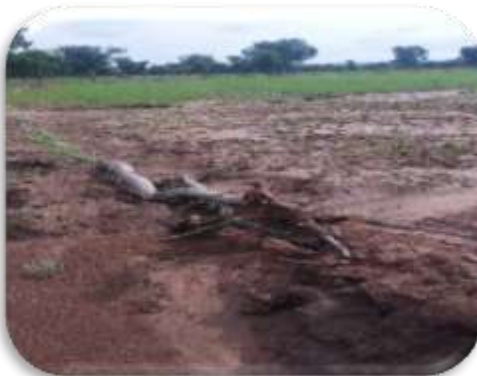
Diguette de séparation emportée
